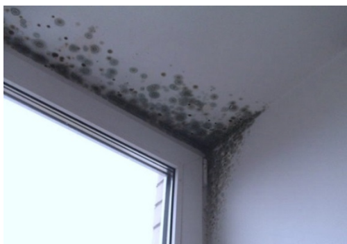
Фото 1 Образование плесени в оконном проеме.
